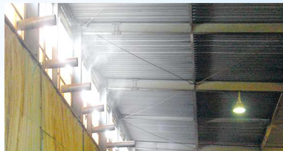
施設内, 噴霧中 (消臭剤メーカー様HPより)
